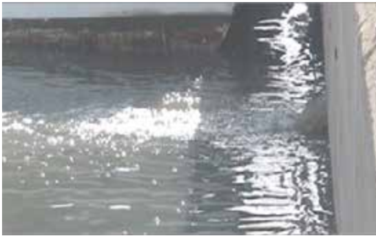
Vertido constante por el aliviadero pluvial del puerto
